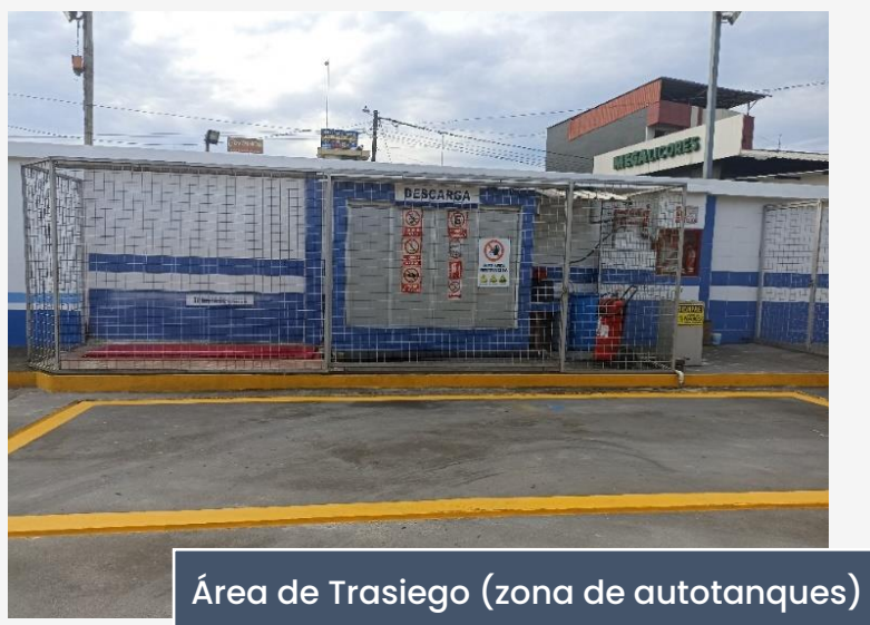
Fotografía 7 - Área de Trasiego (zona de autotanques)
