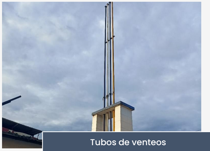
Fotografía 6 - Tubos de Venteo
