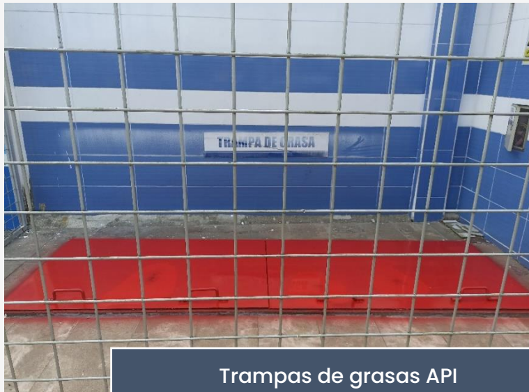
Fotografía 14 - Trampas de grasas
