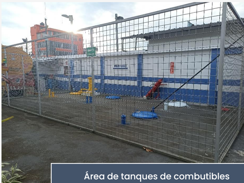
Fotografía 5 - Área de tanques de almacenamiento para combustibles
